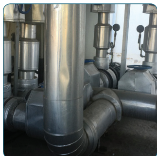
Bao ôn đường ống
