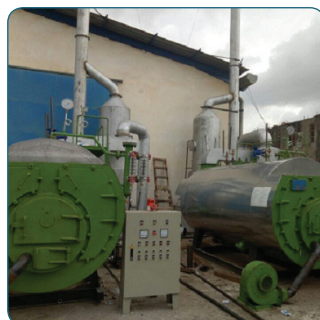
Lò hơi đốt củi và than nén
