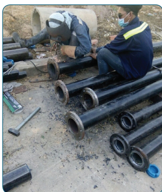
Đường ống dầu
