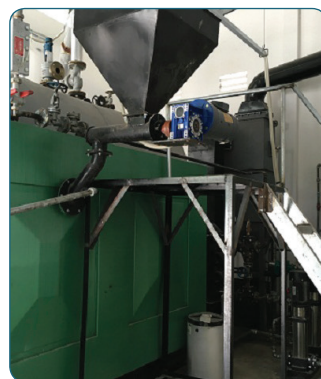
Lò hơi đốt củi và than nén
